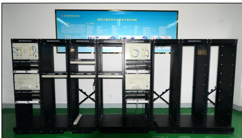
网络工程实训室
